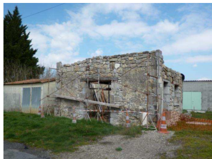
Construction traditionnelle en ruine dans le centre-bourg, Photographie UrbaDoc 2013
