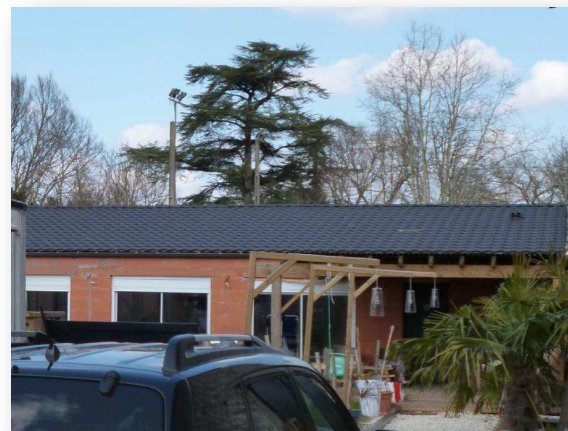
Construction en cours venant densifier le centre ancien : Maison de plain-pied dont la toiture à deux pentes utilise une imitation de la tuile en ardoise : cet élément ne se retrouve pas dans l'architecture traditionnelle, Photographie © UrbaDoc, 2013
