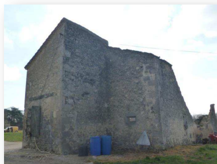
Construction traditionnelle en ruine dans le centre ancien, Photographie © UrbaDoc, 2013
