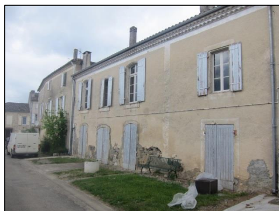
Façade partiellement décrépie, © UrbaDoc 2014
