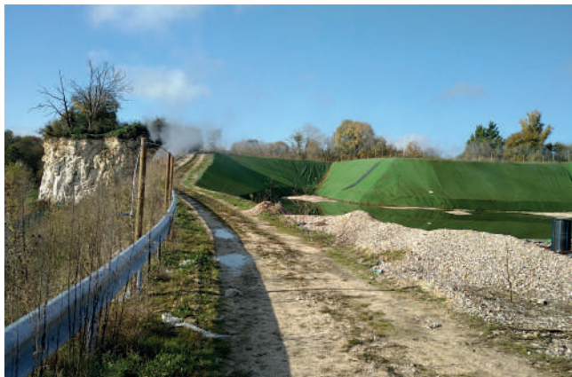
Rampe d'aspersion anti odeurs
