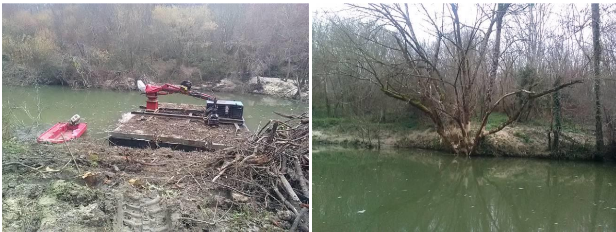
Photo de gauche : barge de travail – photo de droite : érable négundo cerclé et écorcé en vue de son élimination
